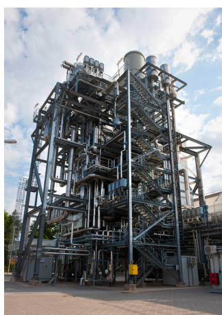
Ansicht der KWK-Anlage
